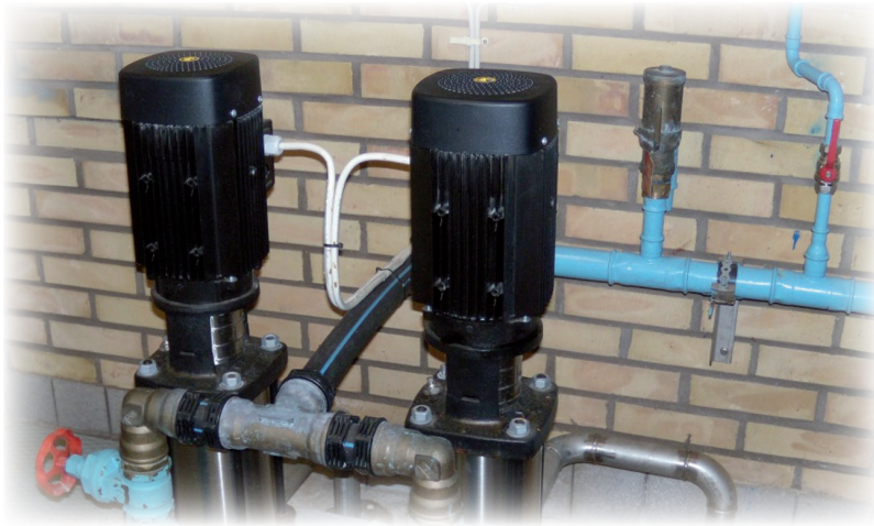
Pumpar från dricksvattendistribution.
